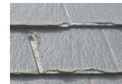
バミール シリーズ： 製品ロッドによってこのような破損が 見受けられる。高圧洗浄時に破損する場合 もあるため注意が必要。
